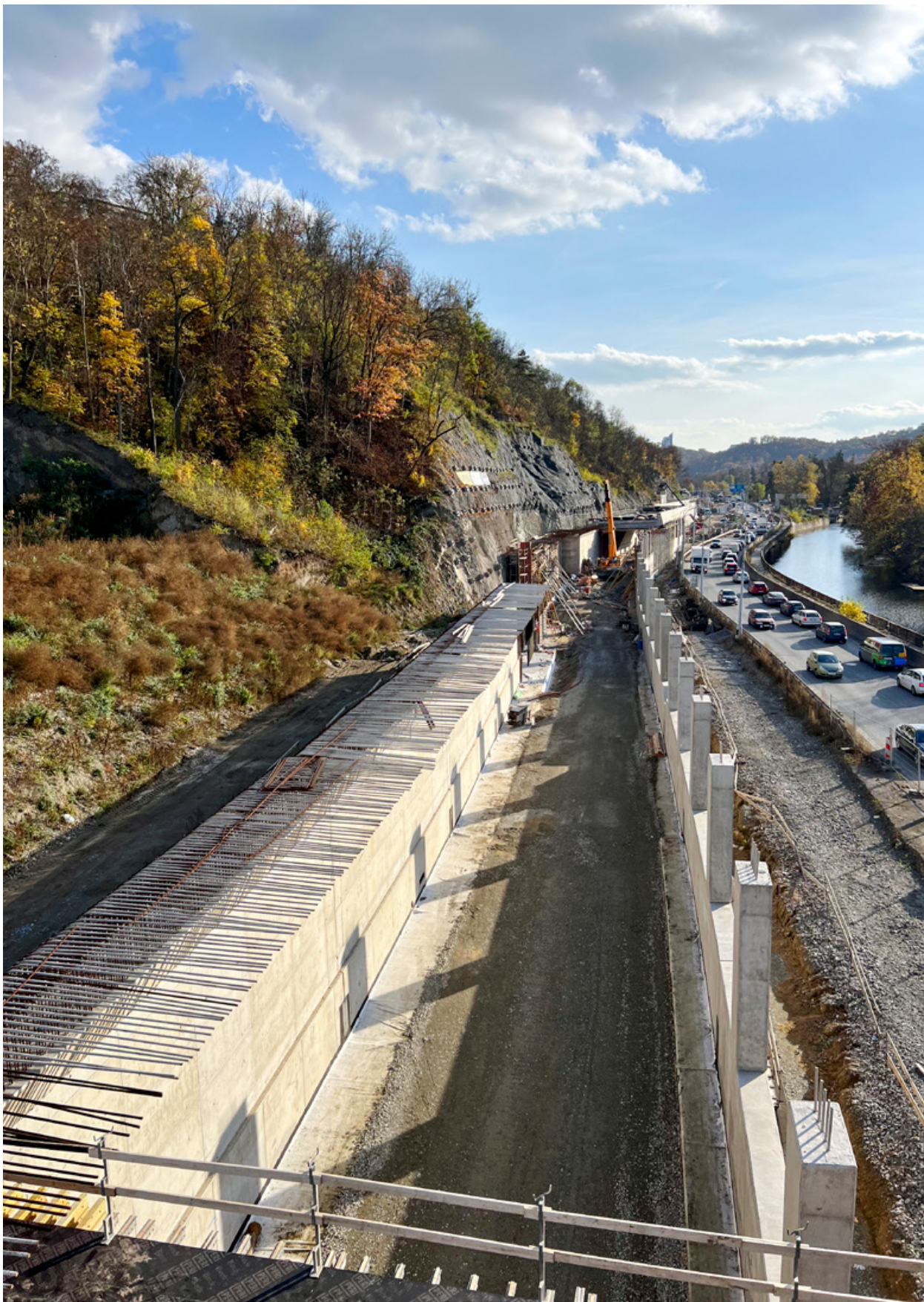
Velký městský okruh Brno má vyhotovený nový 350 m dlouhý úsek vedoucí z Králova Pole směrem k výstavišti. Železobetonové konstrukce pro něj dodal Winning PS Pamstav. Dvouproudová galerie s jednou sloupovou stěnou o sedmi metrech výšky je tvořena z 20 dilatačních celků. Výstavba trvala rok a půl.
